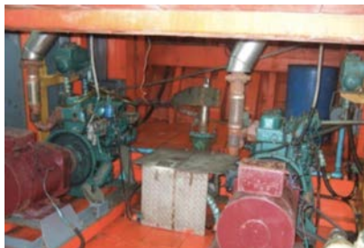
ภาพที่ ๒ เครื่องกำเนิดไฟฟ้าภายในห้องเครื่องยนต์
